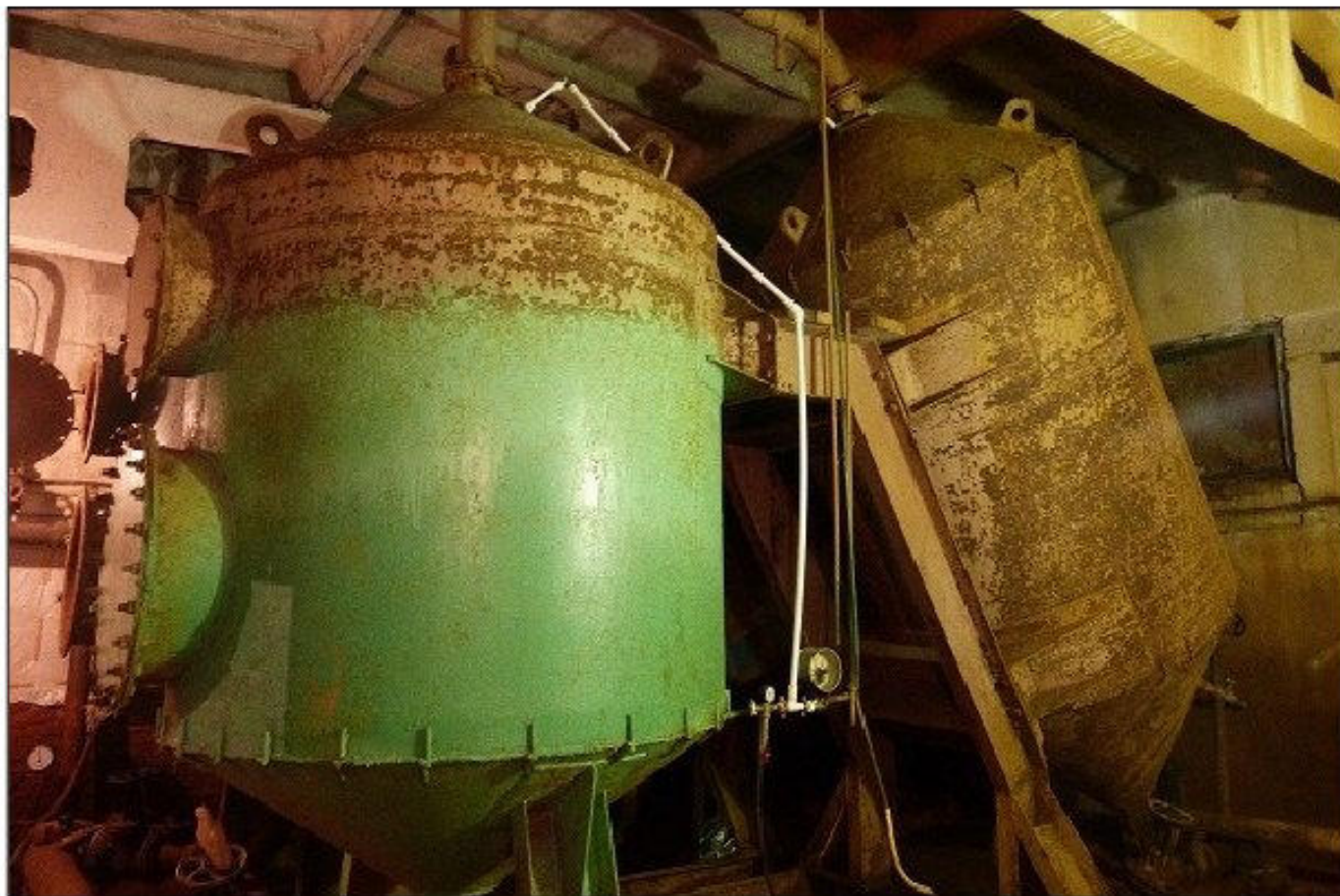
Рисунок ВС-1.10 – Оборудование ВОС в д. Красноозерное
